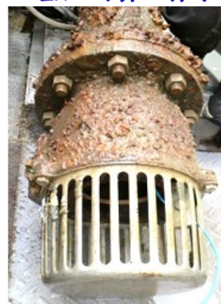
底フート弁の様子
