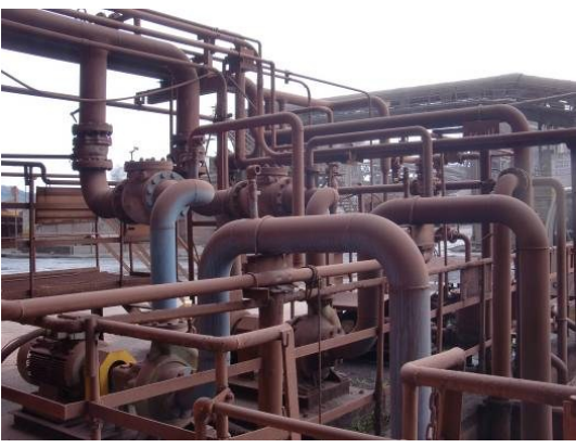
写真① ポンプ廻り
