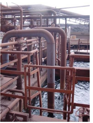
写真② 吸込み配管
