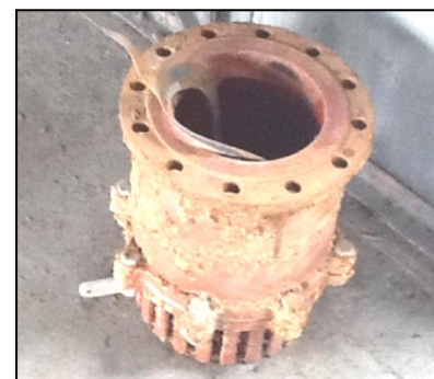
フット弁の劣化状況
