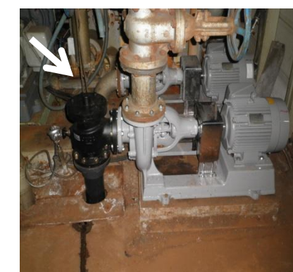
ポンプ吸込側のフート弁
