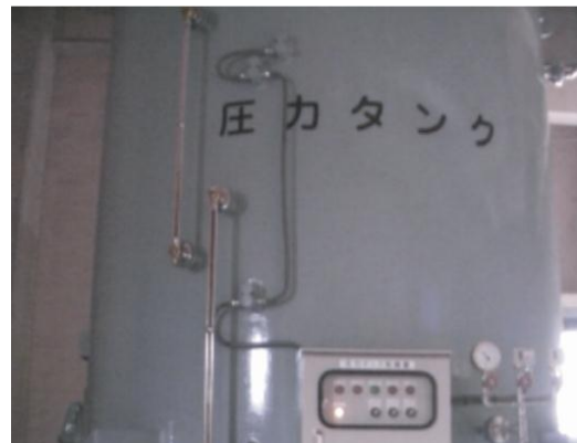
現場圧力タンク
