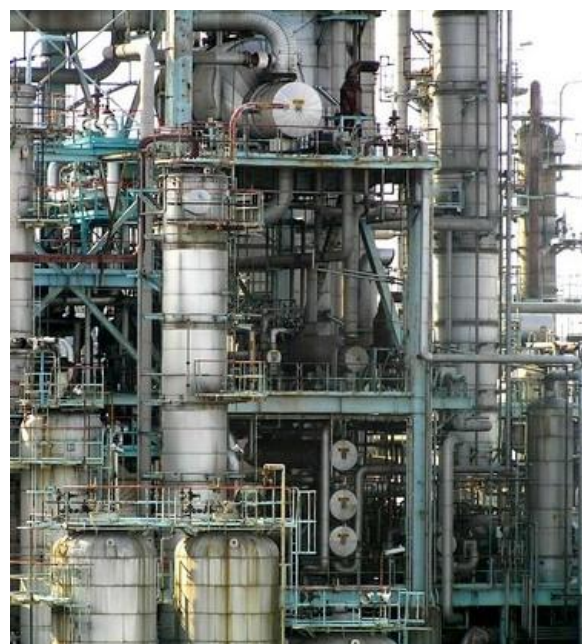
プラントでは24時間可動などの連続運転がチャッキバルブの内部の摩耗を早めています。
